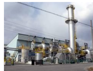
コジェネガス発電所
